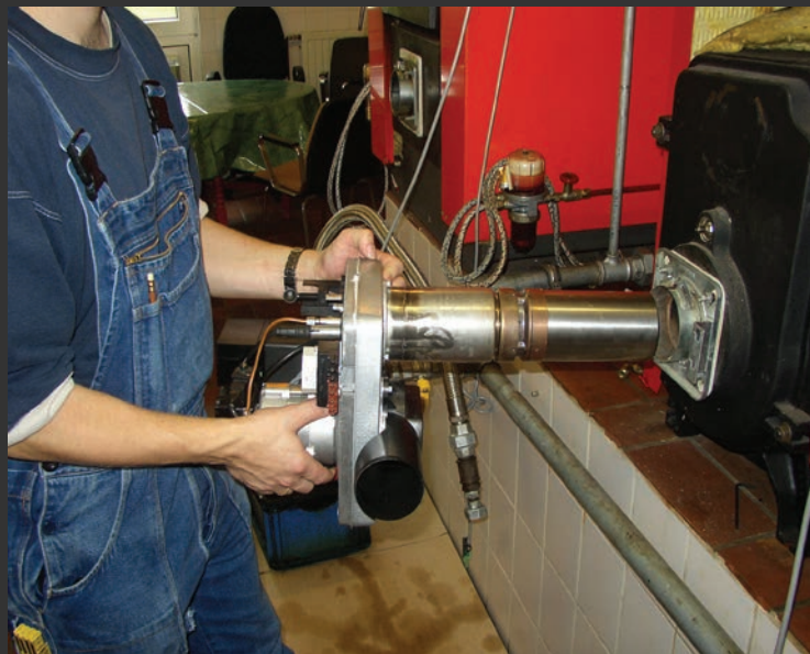
Der Brenner wird durch den Schiebe anschl in den Kessel eingeführt
